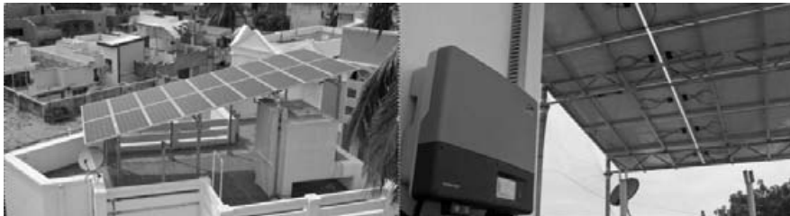
Photo de l'installation solaire photovoltaïque sur le toit et l'onduleur intelligent pour faire le lien avec le réseau.
